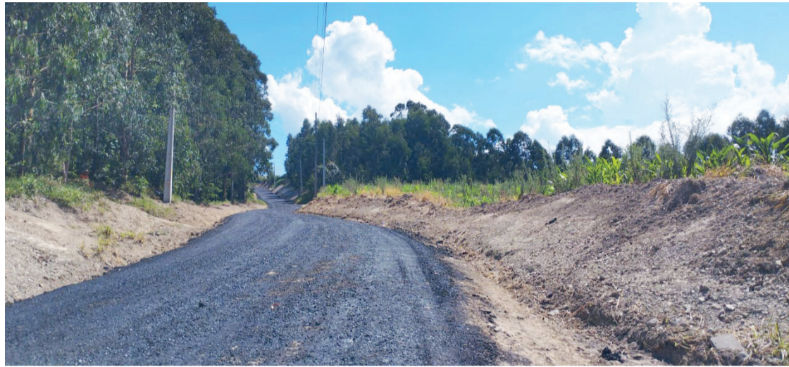
Melhorias na trafegabilidade são essenciais para garantir a segurança dos motoristas
